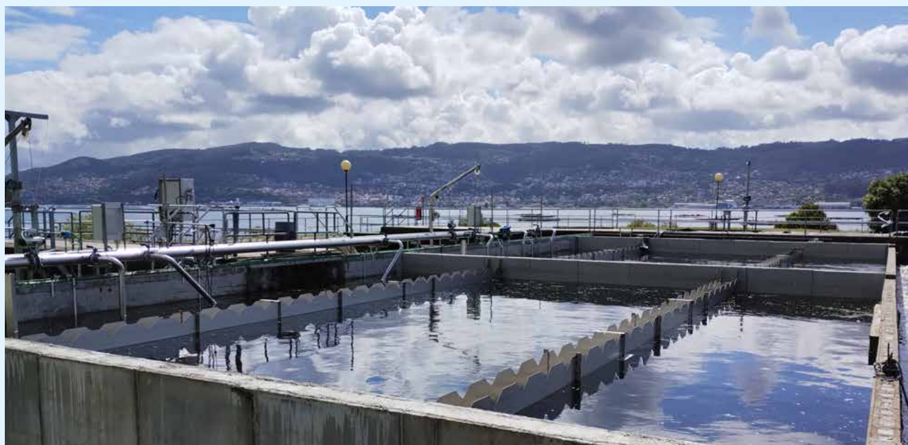
Reactores granulares del proyecto LIFE RESEAU en la EDAR de Moaña.
